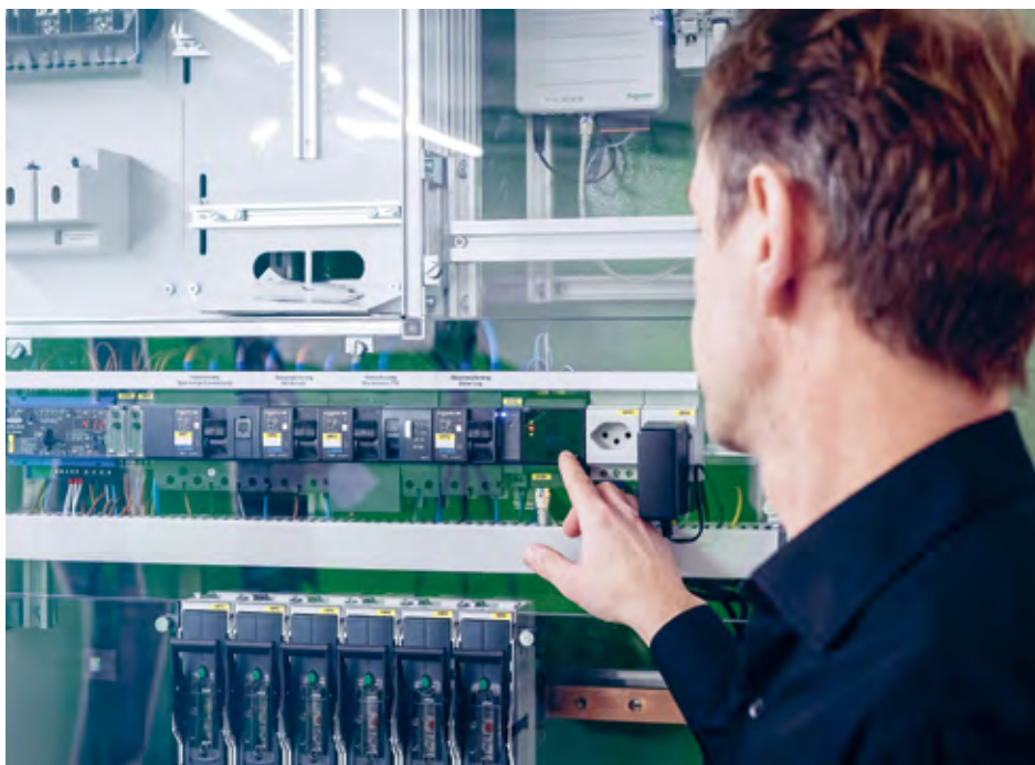
Die Wechselrichter, die den Gleichstrom aus den Solarmodulen in Wechselstrom umwandeln, stammen von Schneider Electric.
