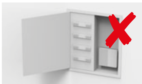
1 Posizionamento errato del router in un quadro di distribuzione dell'appartamento.
