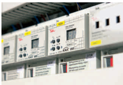
Gli attuatori KNX nella distribuzione al controllo di tutta l'illuminazione
