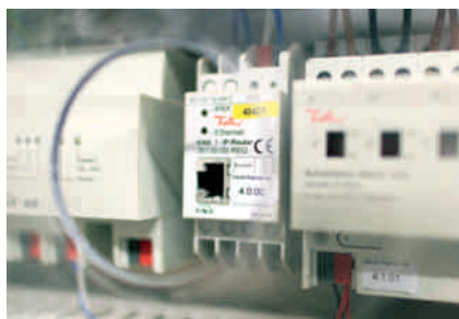
Tramite un'interfaccia IP è possibile azionare ed eseguire la manutenzione dell'intero impianto tramite una WLAN.
