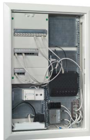
Installazione ibrida conforme a HVA 21 nel distributore Pragma multi (vedere pag. 22)
