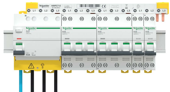
Einspeisung über Clario iC40 Gruppen-FI
