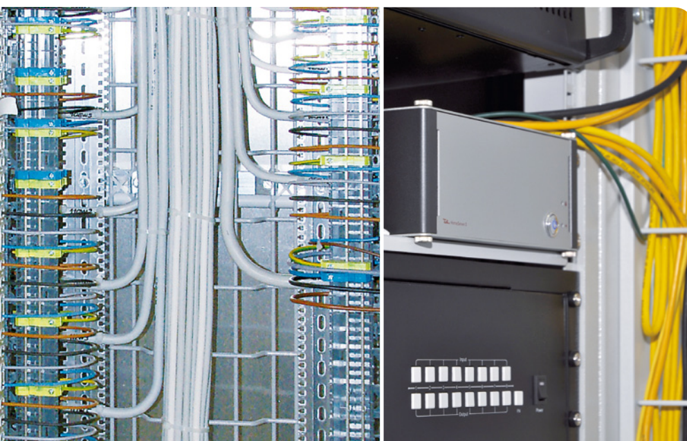
Un coup d'œil sur le câblage ordonné de l'armoire électrique, révélateur du style de travail des intervenants.
